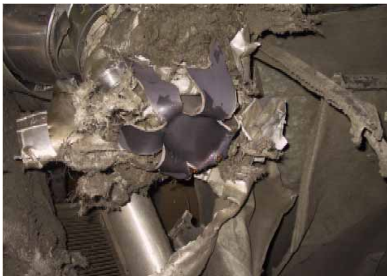
Abbildung 4.4 Geplatzttes Rohr im AKW Brunsbüttel (Hirsch 2005)
